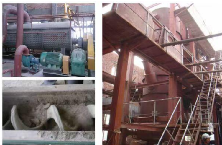
图 4 温州污泥干化焚烧系统
