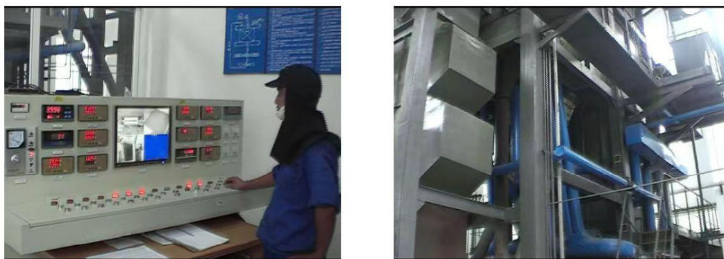
图 6 浙江圣雄制革污泥焚烧工程
