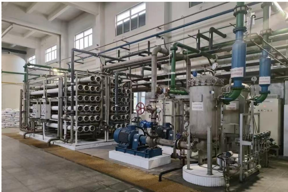
图 1 废水处理技术在电厂实际应用场景
