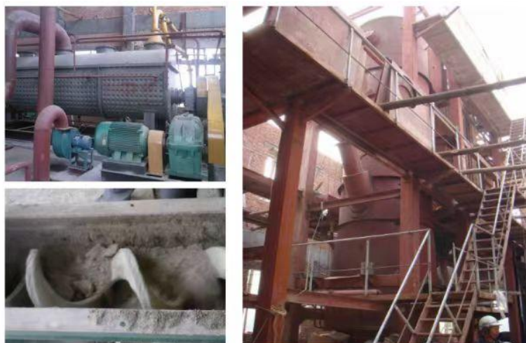
图 4 温州污泥干化焚烧系统
