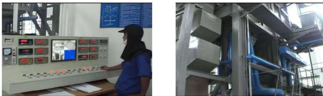
图 6 浙江圣雄制革污泥焚烧工程
