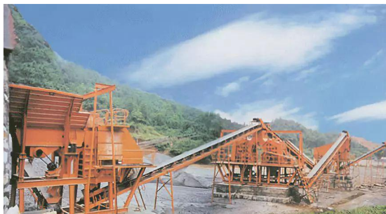
图 10 国内的固定破碎筛分生产线
