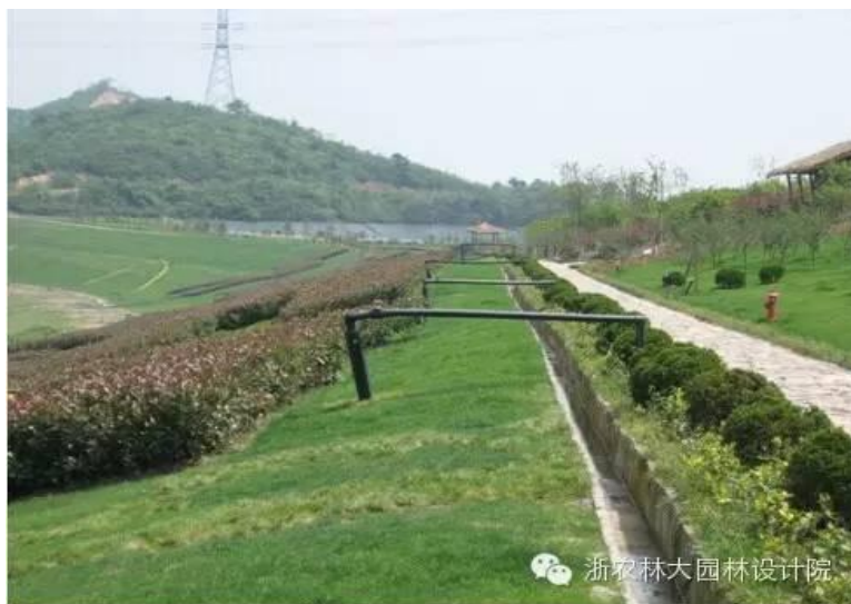
图 5 公园下垃圾填埋场的甲烷气体收集管道
