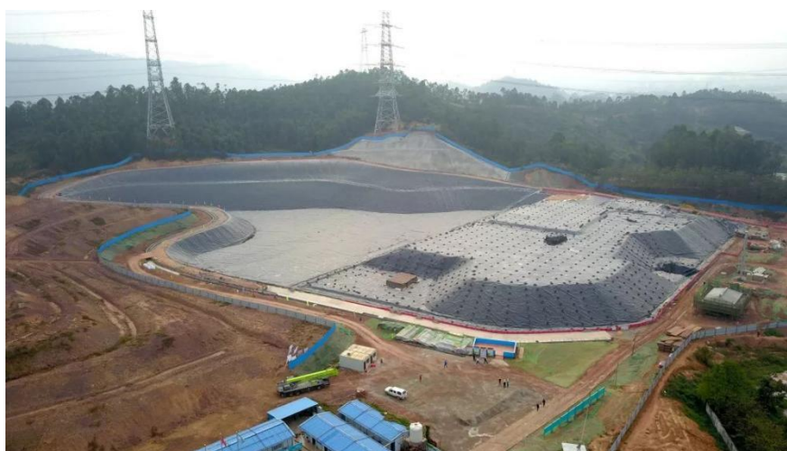
图3 东莞市东南部卫生填埋场一期工程高效投产运营
